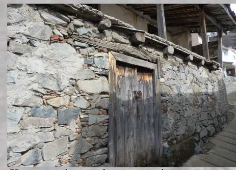
Κατασκευή οροφής κατωγιού. Βολίτζια από κορμούς δέντρων, σανίδωμα και άργυλος πεισμένος. Μερικές φορές τοποθέτηση πλακών.
